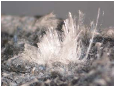
Figura A1.3 Material con amianto CRISOTILO (60 X)
