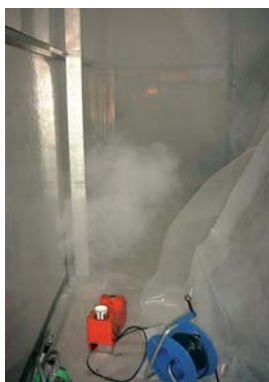
Figura A3.9 Control de la eficacia del confinamiento mediante una prueba de humo
