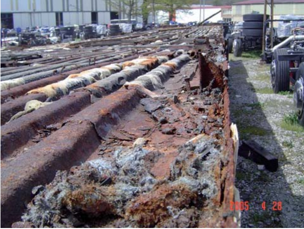
Figura A3.27a Residuos incontrolados de crocidolita retirados de vagones de ferrocarril
