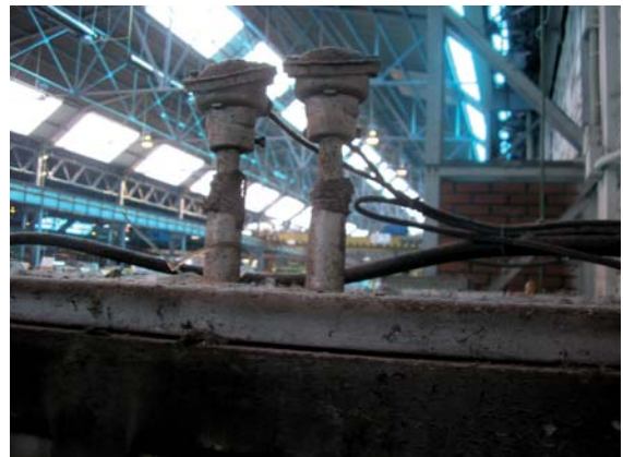
Figura A1.36 Aislamientos eléctricos en un horno
